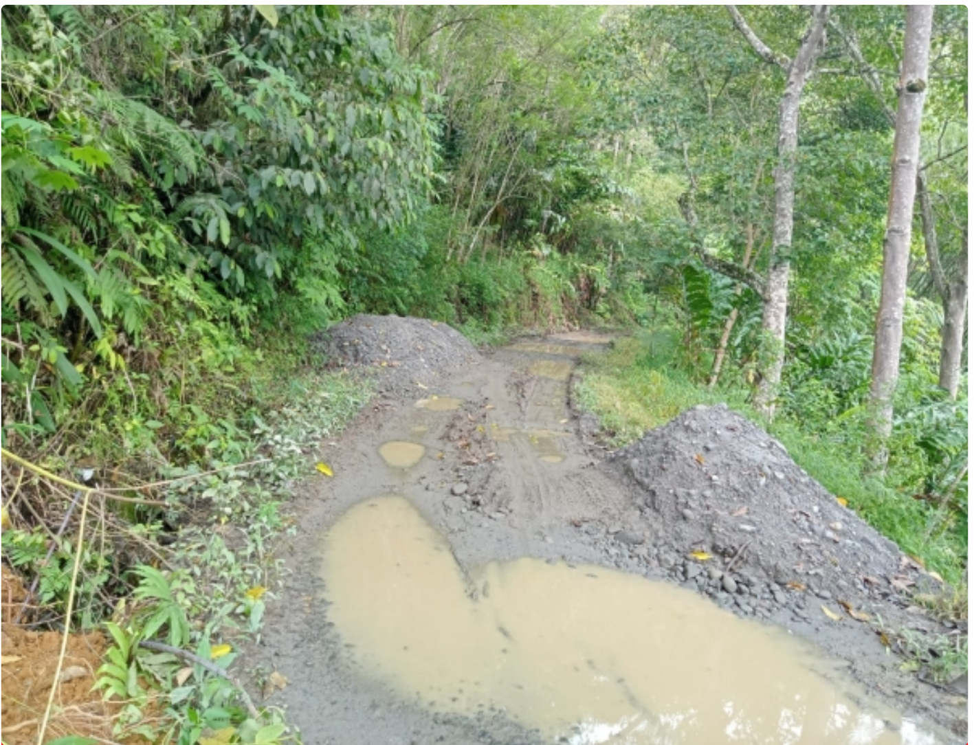
Kondisi Jalan Poros Desa Kidupen - Lau Lingga Kecamatan Juhar, Kabupaten Karo, Jumat (23/12-2022)
